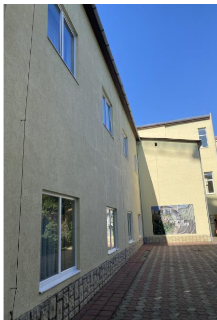
Будівля обладнана блискавкозахистом
